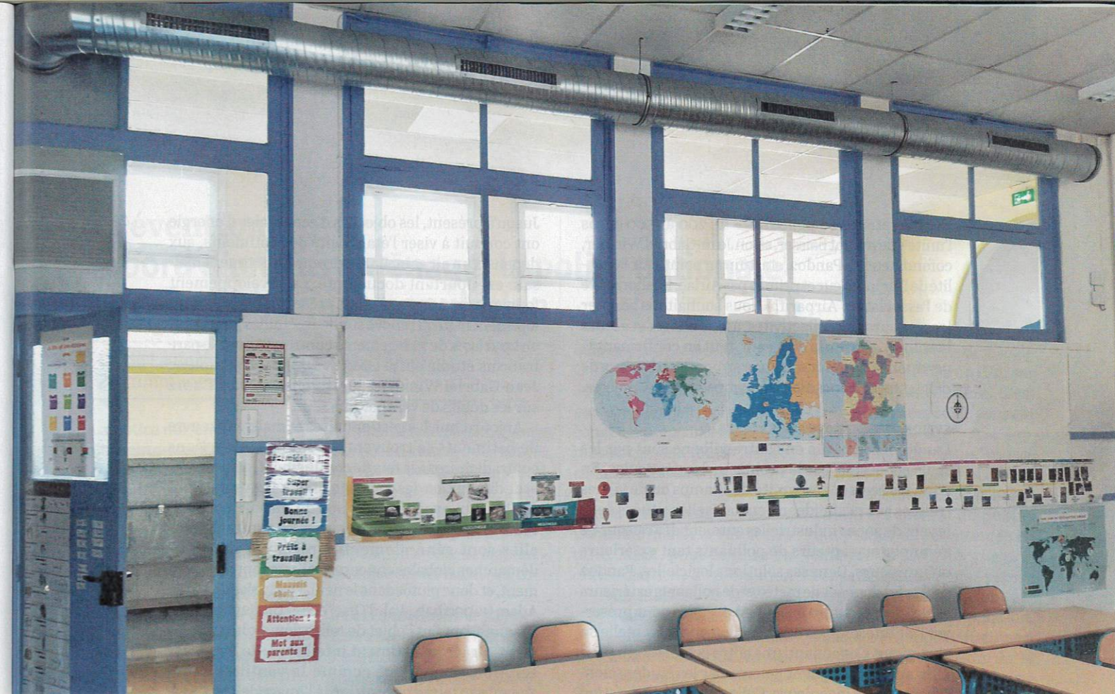
A l'école La Fontaine, au Raincy, un système placé en hauteur distribue l'air purifié. Il est relié à des capteurs de mesure de la qualité de l'air intérieur. AIRQUALITY / VEOLIA
